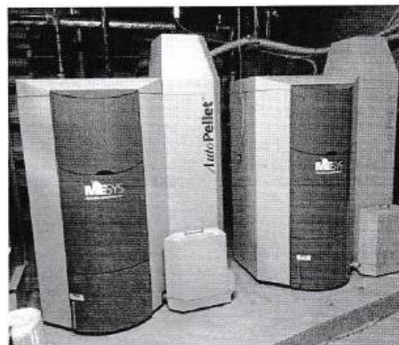
Nouvelles chaudières aux granules de bois. Crédit photo : Jacinthe Cyr
